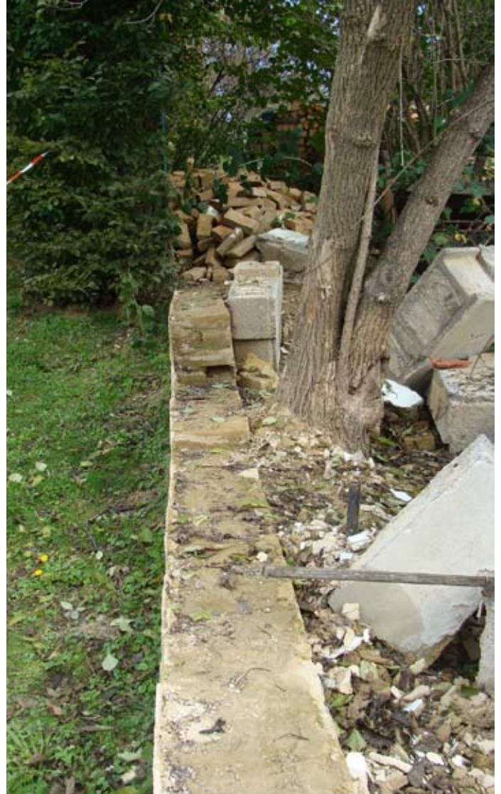
In Realität, war selbst in abgetragenen Zustand eine leichte Neigung erkennbar
