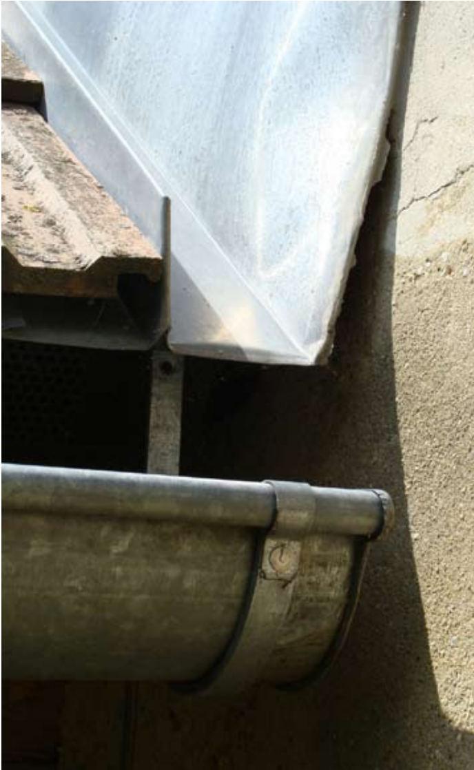
Verblechung ursprünglich satt, ist 2014 bereits cm-weit von der Mauer entfernt
