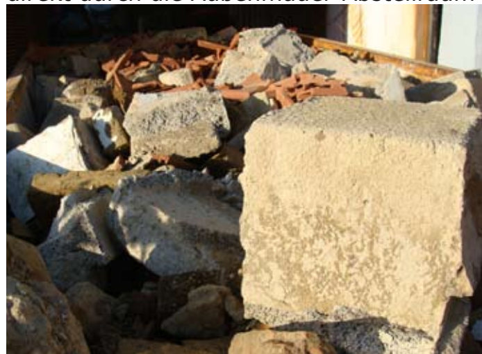
Betonklötze 40x40x60 im inneren der kippenden Wand zum Nachbarn
