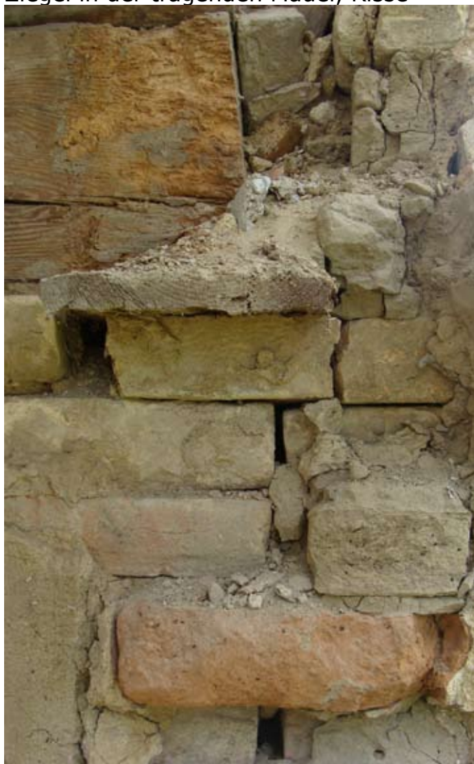
Die Fugen und Schäden am Holz weisen auch auf einen Wasserschaden hin
