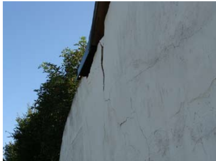
2014 - Putz der tragenden Mauer am Nord eck bricht sichtbar
