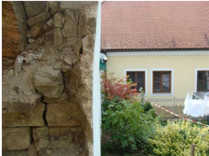
Druck und Feuchtigkeit spalten bereits Ziegel in der tragenden Mauer, Risse
