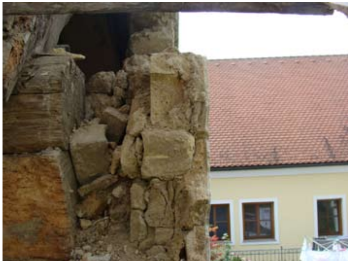
2014 Tragende Mauer reisst bereits im Eck durch.
