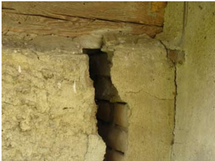
2014 Mauerriss bereits Unterarmbreite erreicht
