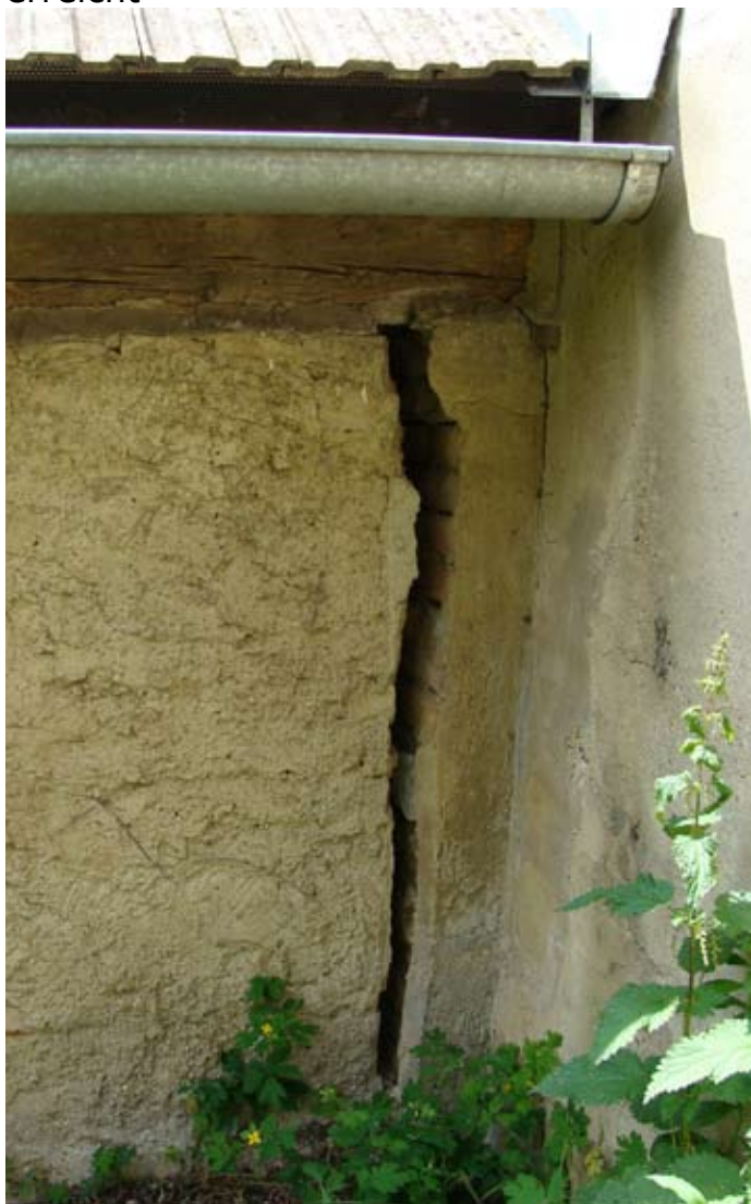
2014 - Mauerriss reicht bereits über die gesamte Länge der Wand
