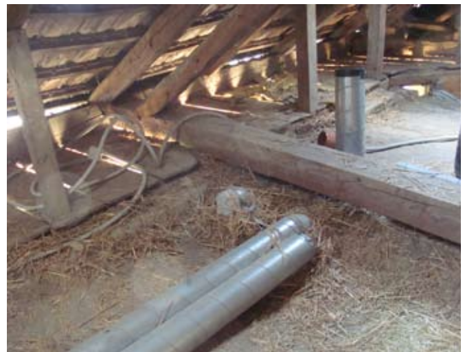
ORT: Schlafzimmer alt, Entlüftung ungesichert INS Dach
