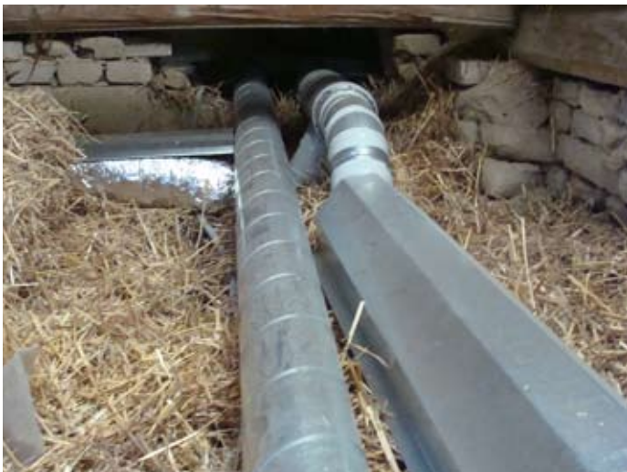
ORT: Leitung NEU vom Vorzimmer-Knoten - Richtung Küche-Ventil Abzweigung
