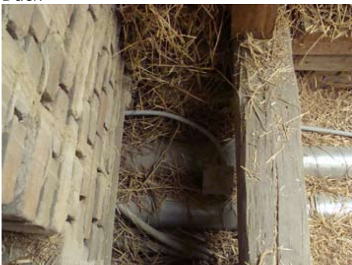
ORT: Leitung Dachdurchstoß Küche-Bad
