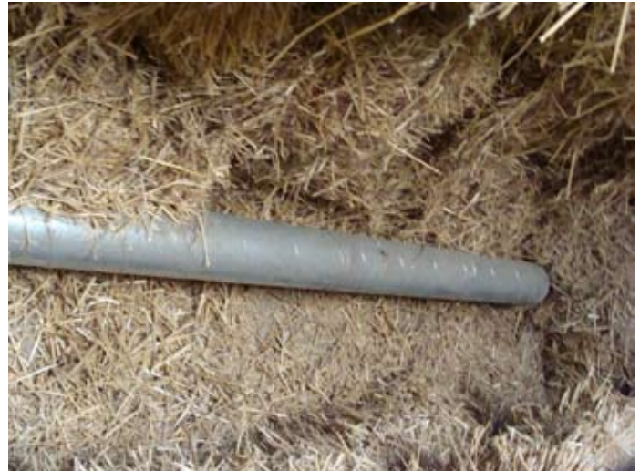
ORT: Leitung, Endpunkt JA Ex-Zimmer, vorderes Dach
