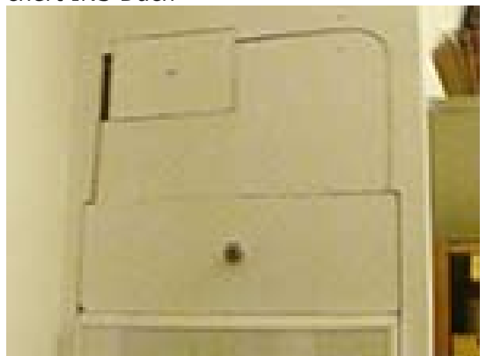
Ventilatoren kaputt, seit 2008/10 außer Betrieb
