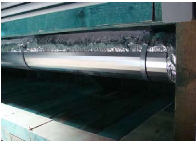
ORT: Abluft Ausgang - Schalldämmung im Laubengang - geschützt montiert
