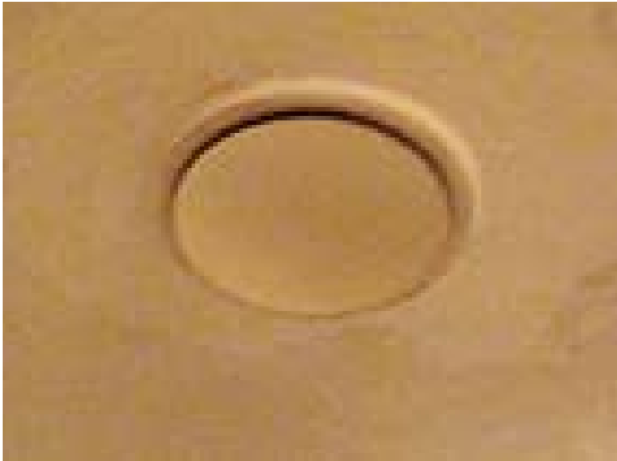
ORT: JU-Ex-Zimmer Kondenswasserschaden behoben und Schäden beseitigt
