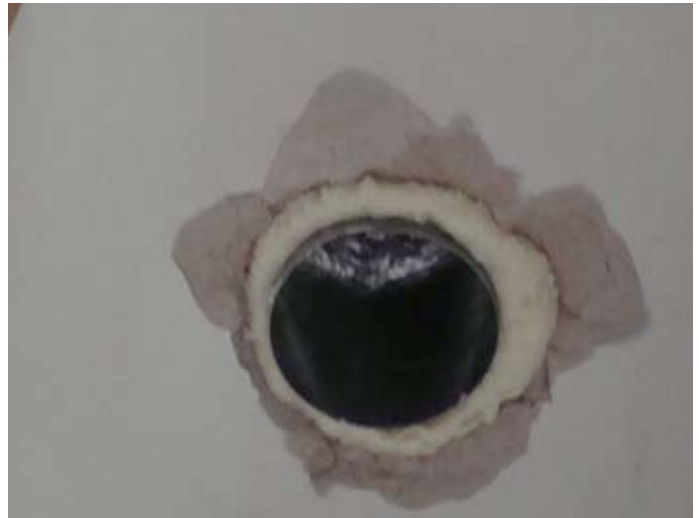
ORT: Ex-Schlafzimmer - DICHTER Ventilanschluss für Wandventil
