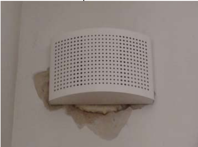
ORT: Ex-Schlafzimmer - Wandventil ist durch ein WAND-Ventil ersetzt worden
