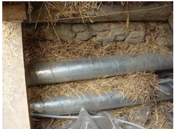
ORT: Leitung vom Knotenpunkt Vorzimmer zu den Dachkanten Küche-Bad
