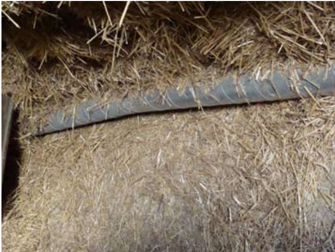
ORT: Leitung zu Endpunkt JA Ex-Zimmer, vorderes Dach
