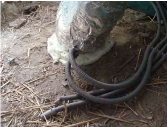
ORT: Abluft Ausgang - DICHT fixiert NEU - Ex-Schlafzimmer
