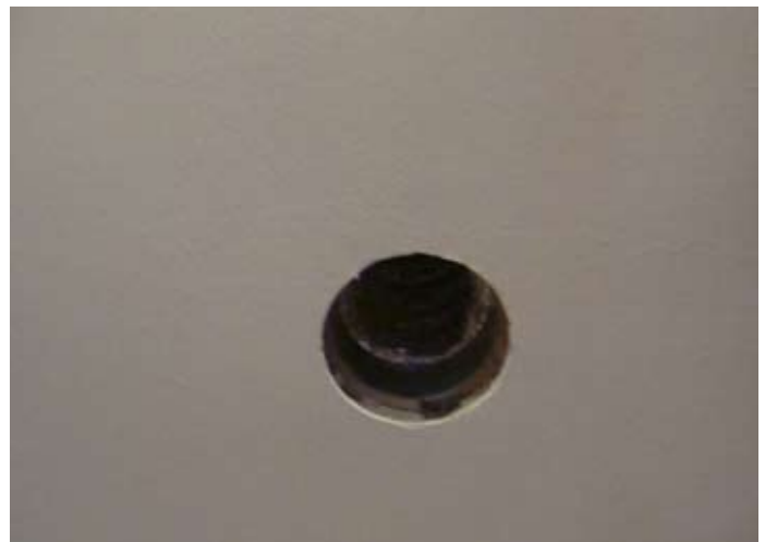
ORT: Speis NEU - Fensterlos - ergänzt, Probleme mit aufsteigender Feuchtigkeit..
