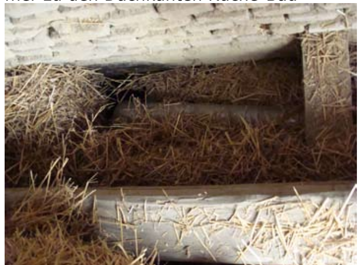
ORT: Leitung zum FEHLENDEN Küchen-ventil
