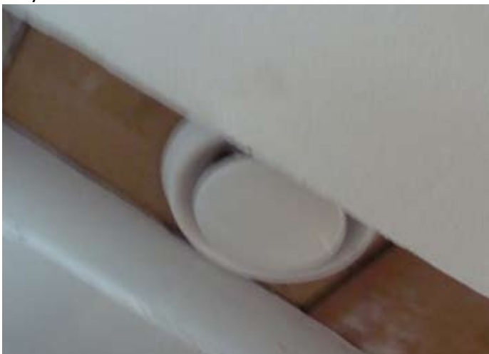
ORT: Küche NEU - Fehlendes Ventil wieder ergänzt
