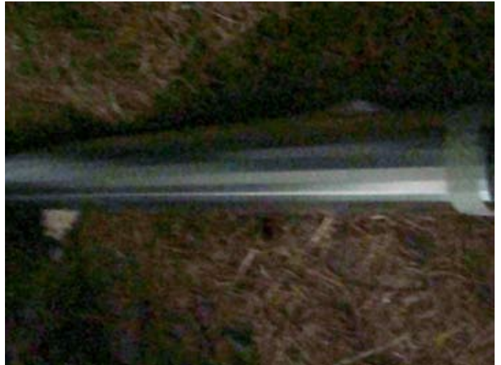
ORT: Leitung NEU: Vom Vorzimmer Ventil, Leitung Richtung Ex-Wohnzimmer
