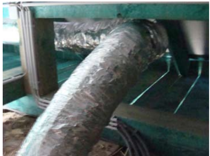
ORT: Abluft Ausgang - Schalldämmung über Laubengang
