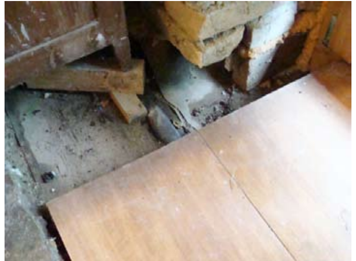
Durch das Loch in der Außenmauer drang das Wasser in die Vertiefung im Boden ein
