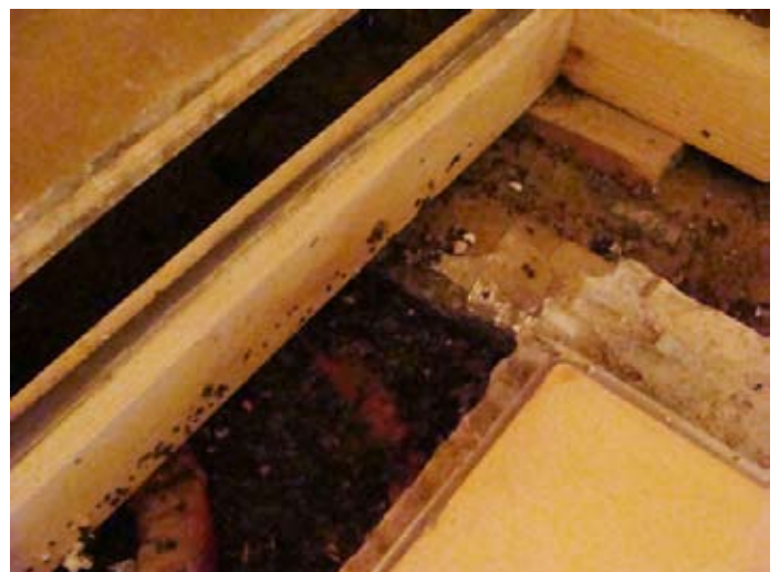
Das Wasser verteilte sich in Kürze rund je 2 m von der Tür weg in den Raum
