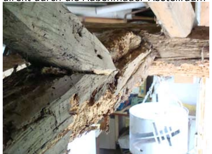
Das tragende Gebälk bereits geschädigt. Durch Kontrolle erkennbar gewesen.
