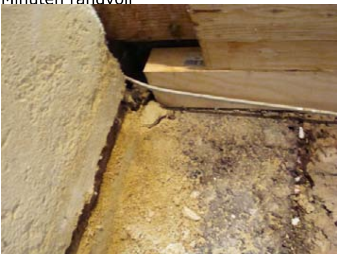
Der Installationsschacht erwies sich als perfekte Wasserstraße
