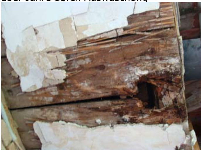
Jahrelang missachtete Wasserflecken, führten schließlich zur Zerstörung
