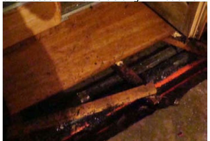
Das Wasser drängte durch den durchfeuchteten Boden (unbemerkt Wasser eindrang durch die Wand) ins Büro
