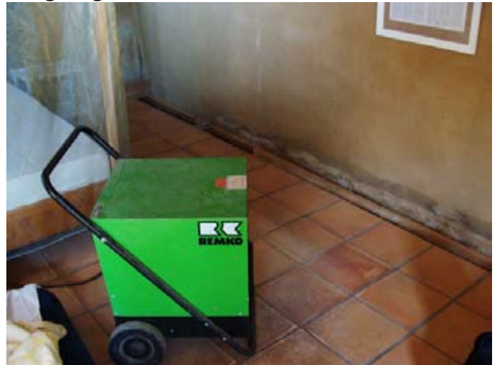
Entlüfter waren gut zwei Monate in Betrieb - mit mäßigem Erfolg.
