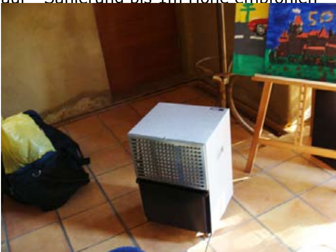
Die Sanierung ist bis heute ungelöst
