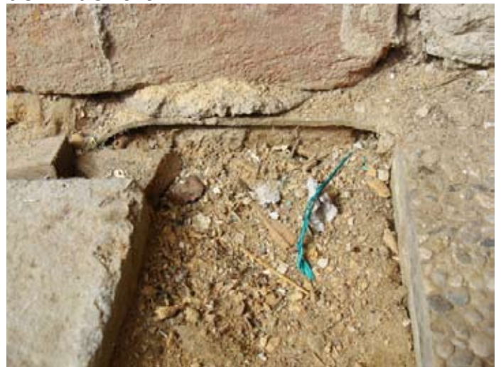
Unterarmgroßes Loch durch Auswaschung direkt durch die Außenmauer-Abstellraum
