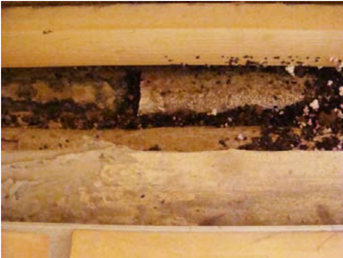
Die Dämmung wurde durchfeuchtet. Die Tür lässt sich nur mit Gewalt öffnen.
