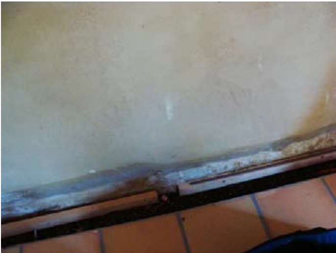
Feuchtigkeit zog sich bis in den Putz hinauf - Sanierung bis 1m Höhe empfohlen
