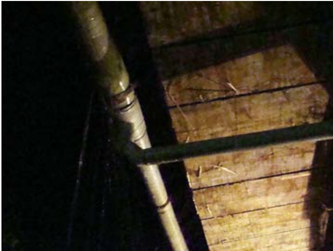
Für 110 m 2 Dachfläche 1! Regenrohr - und dieses hat Kleingarten-Dimension
