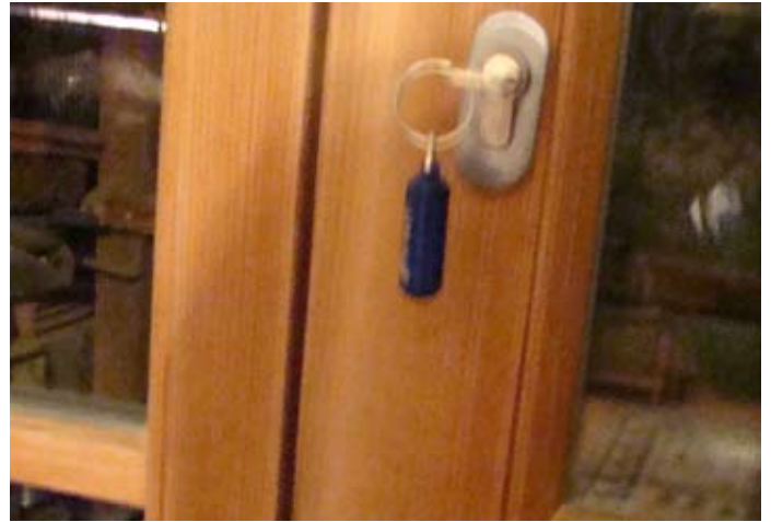
Nur 2 der 7 Außentüren versperrbar, fehlende, funktionstüchtige Schlösser FOLGE: Einbruchgefahr, Kältebrücken
