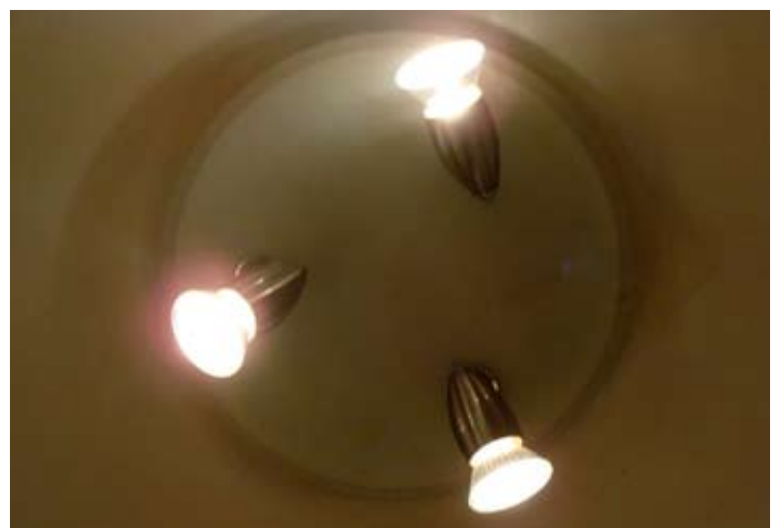
Nur mit 1 statt 3 Schrauben befestigt FAHRLÄSSIG: 11/2013 löste sich die Mischschraube auch noch, hing am Kabel!
