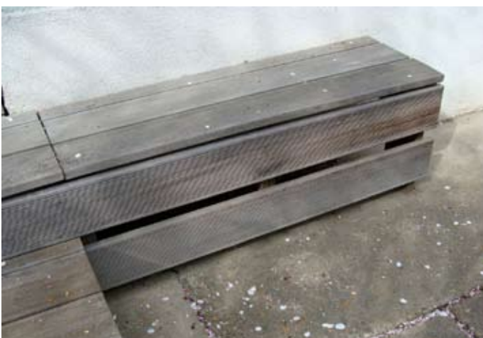
Deckel nicht begehbar FAHRLÄSSIG: Einsturzgefahr-die Kids sehen das als Treppenverlängerung
