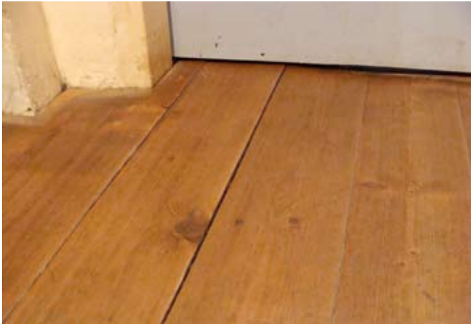
Schiefsitzender, verkalkter Siphon FOLGE: Holzfußboden stellte sich bereits auf, jetzt Setzungen durch Trocknung.
