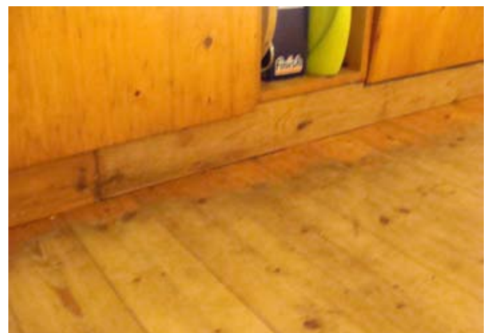
VERWAHRLOSUNG: Fehlende Abschlussleiste ersetzt. Vielleicht Absicht, wegen Schimmelbildung?
