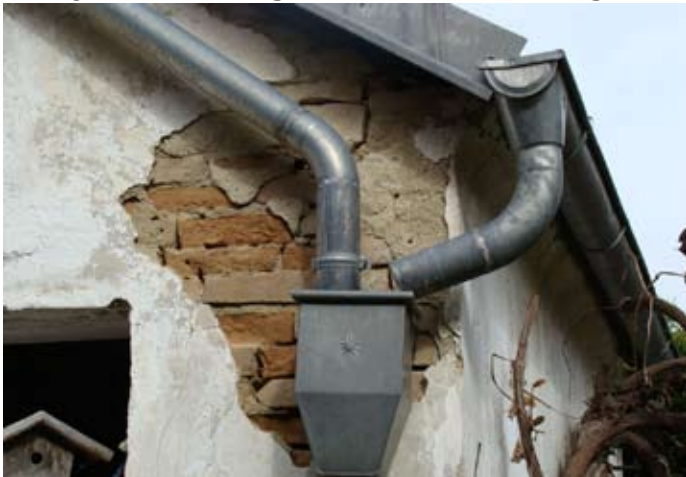
Von der Weinrebe nach oben geschobene Dachziegel ließen Wasser eintreten FOLGE: Mauerwerk geschädigt
