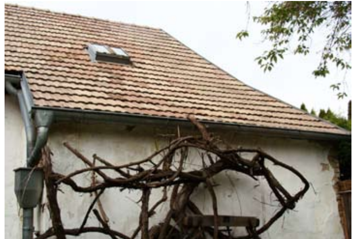
Von der Weinrebe nach oben geschobene Dachziegel ließen Wasser eintreten FOLGE: Mauerwerk geschädigt
