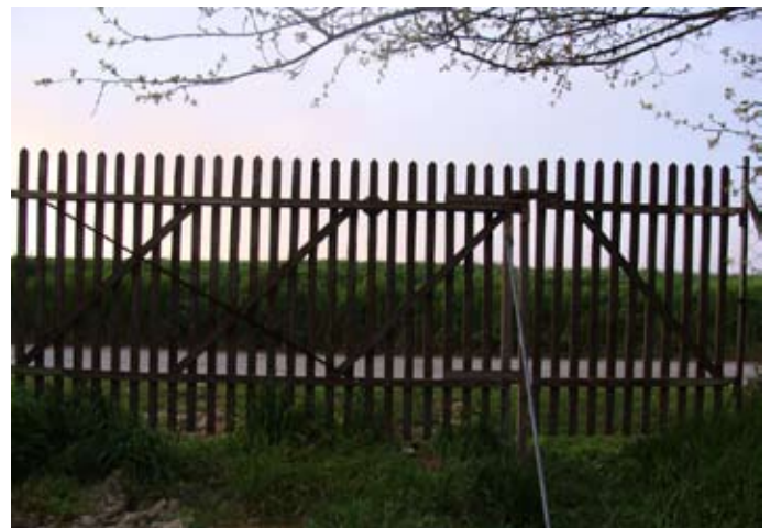
VERWAHRLOSUNG: Gartentor: Riegel ist defekt, Tor instabil
