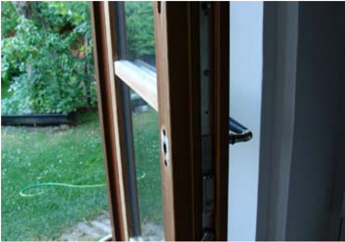
Kältebrücke durch fehlende Dämmung FOLGE: Schimmelbildung, Tür lässt sich nicht ganz öffnen
