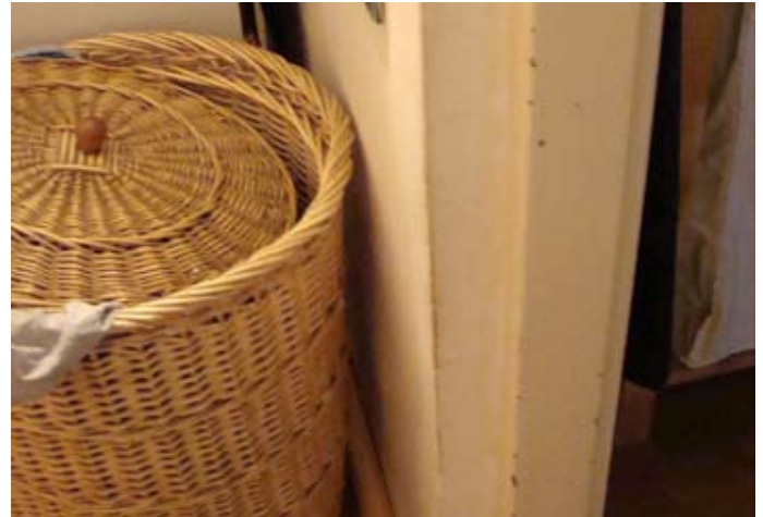
VERWAHRLOSUNG: Das Haus insgesamt in einem jämmerlichen Zustand: Abgewohnt, beschädigt, fehlende Teile....
