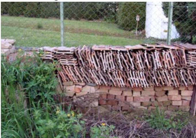
VERWAHRLOSUNG: Abgrenzung zum Nachbarn gibt wegen des Niveauunterschiedes nach
