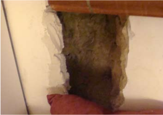
VERWAHRLOSUNG: Ruhende Baustelle - Küche, direkt neben dem Esstisch. Spinnennistplatz...
