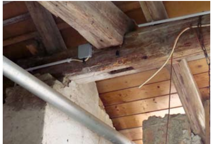
Von der Weinrebe nach oben geschobene Dachziegel ließen Wasser eintreten FOLGE: Holzbalken geschädigt-wie hier
