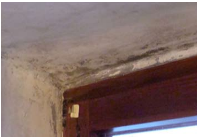
Stilllegung Lüftung + Dichtigkeit gehoben FOLGE: Mit der steigenden Grundfeuchte im Haus - Schimmelbildung (Küche)
